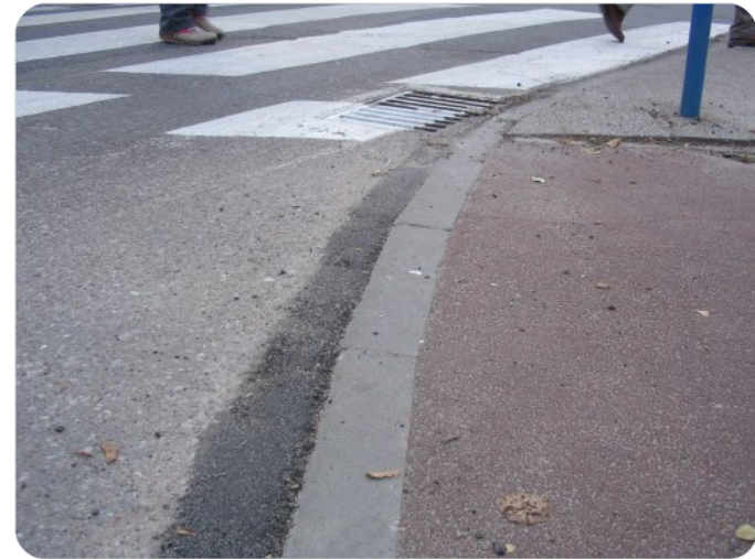
Uskok między jezdnią a drogą rowerową wyrównany przy pomocy masy bitumicznej (Gdańsk, ul. Wyspiańskiego róg Danusi).
